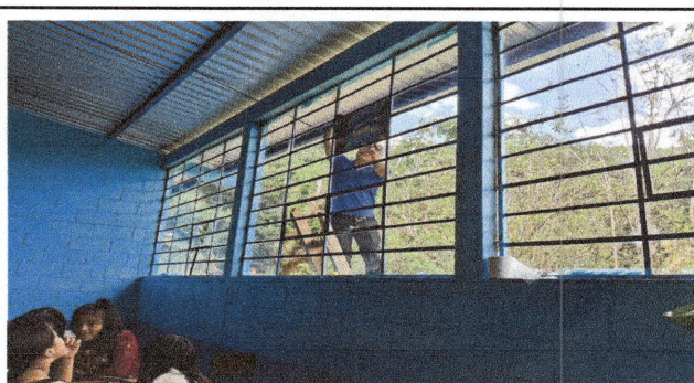
Foto 10: cambio de vidrios en módulo 2
